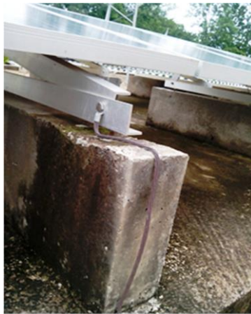
รูปที่ 147 การต่อสายดินที่กรอบโลหะของแผงเซลล์แสงอาทิตย์
