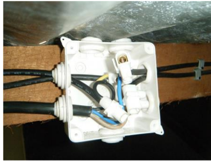
รูปที่ 71 กล่องแยก (Junction Box)
