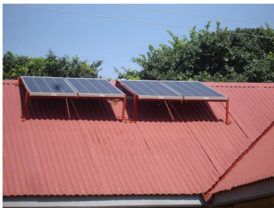
รูปที่ 97 แผงเซลล์แสงอาทิตย์ติดตั้งอยู่บนหลังคาแหลม
