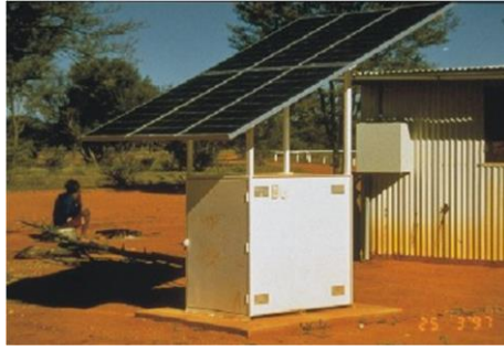
รูปที่ 78 แหล่งจ่ายกระแสไฟฟ้าเพื่อให้แสงสว่าง
